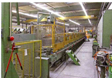
Erfasst wird die Leistung pro Motor nebst Summe aller Motorenleistungen. Bild: Netzwerkdraht
